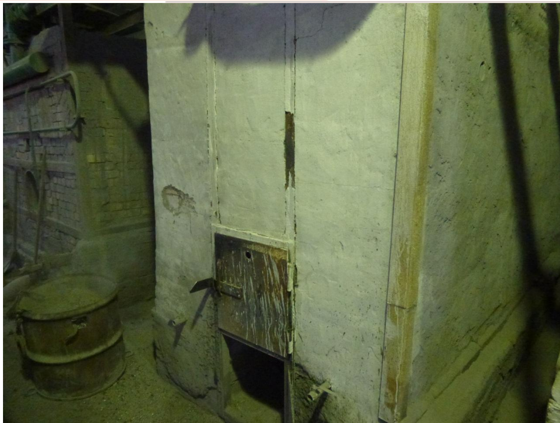
Рис.3. Фотография котла, на котором проводились испытания.
