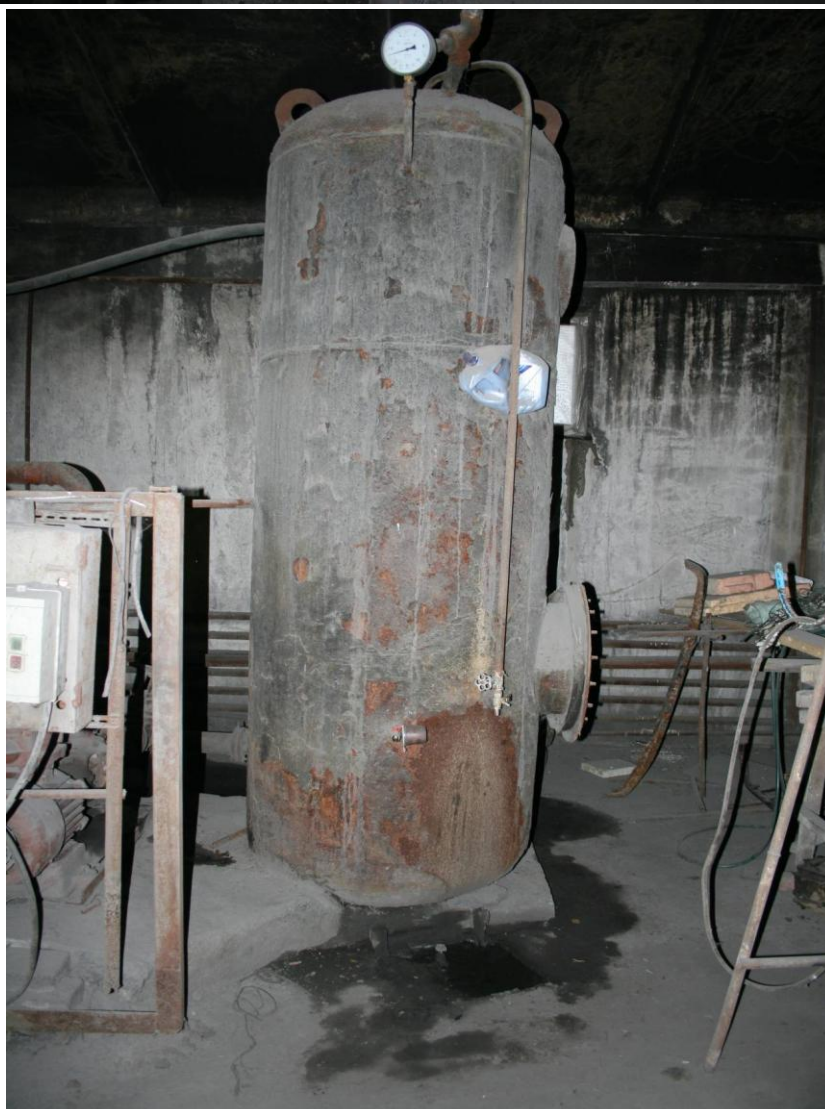
Рис.1. Котел, на котором проводились испытания.
