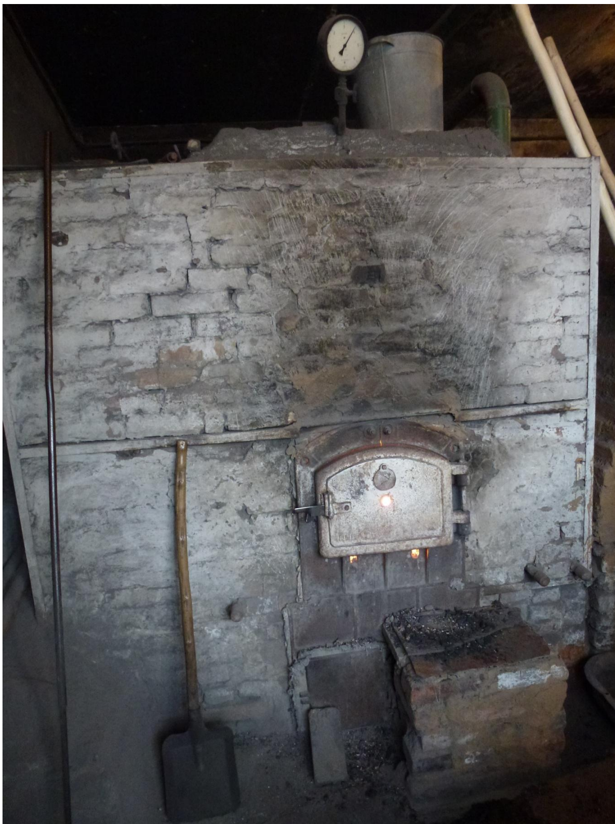
Рис.2. Фотография котла, на котором проводились испытания.
