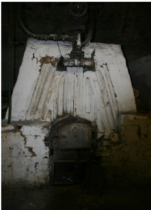
Рис.№2. Фотография котла, на котором проводились испытания
